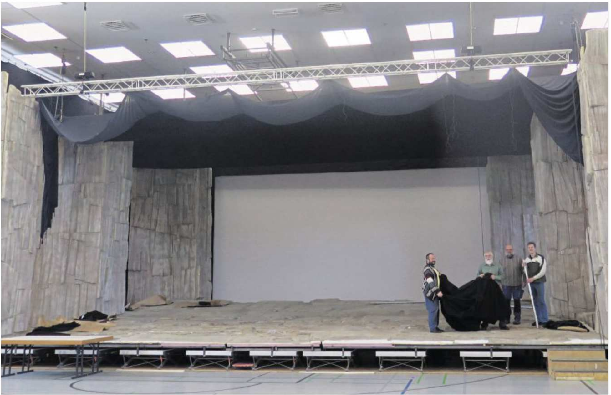
Etwas verloren wirken Erwin Popp, Peter Hackl, Wolfgang Hesel und Bernd Schraml (von links) auf der Bühne. Doch die Bühnenarbeiter wissen genau, was sie zu tun haben. Ende Januar soll der Rahmen für die Kemnather Passion bereit stehen. Bild: jzk
